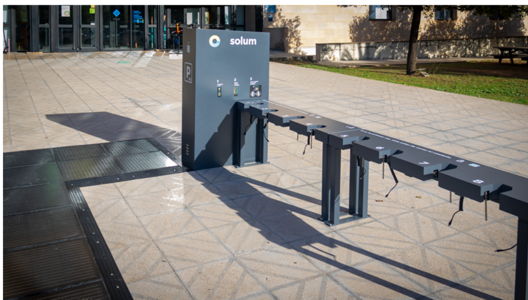
Il·lustració 28. Punt de recàrrega elèctrica per a patinets. Font: UIB
